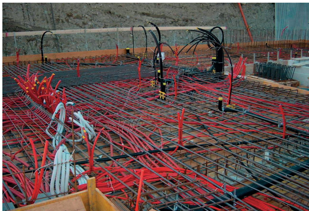
Die korrekte und genügend gross dimensionierte Verrohrung als Voraussetzung für Vernetzung – hier ein Blick in eine Betondecke in Luginbühls Wohn- und Arbeitsräumen.
